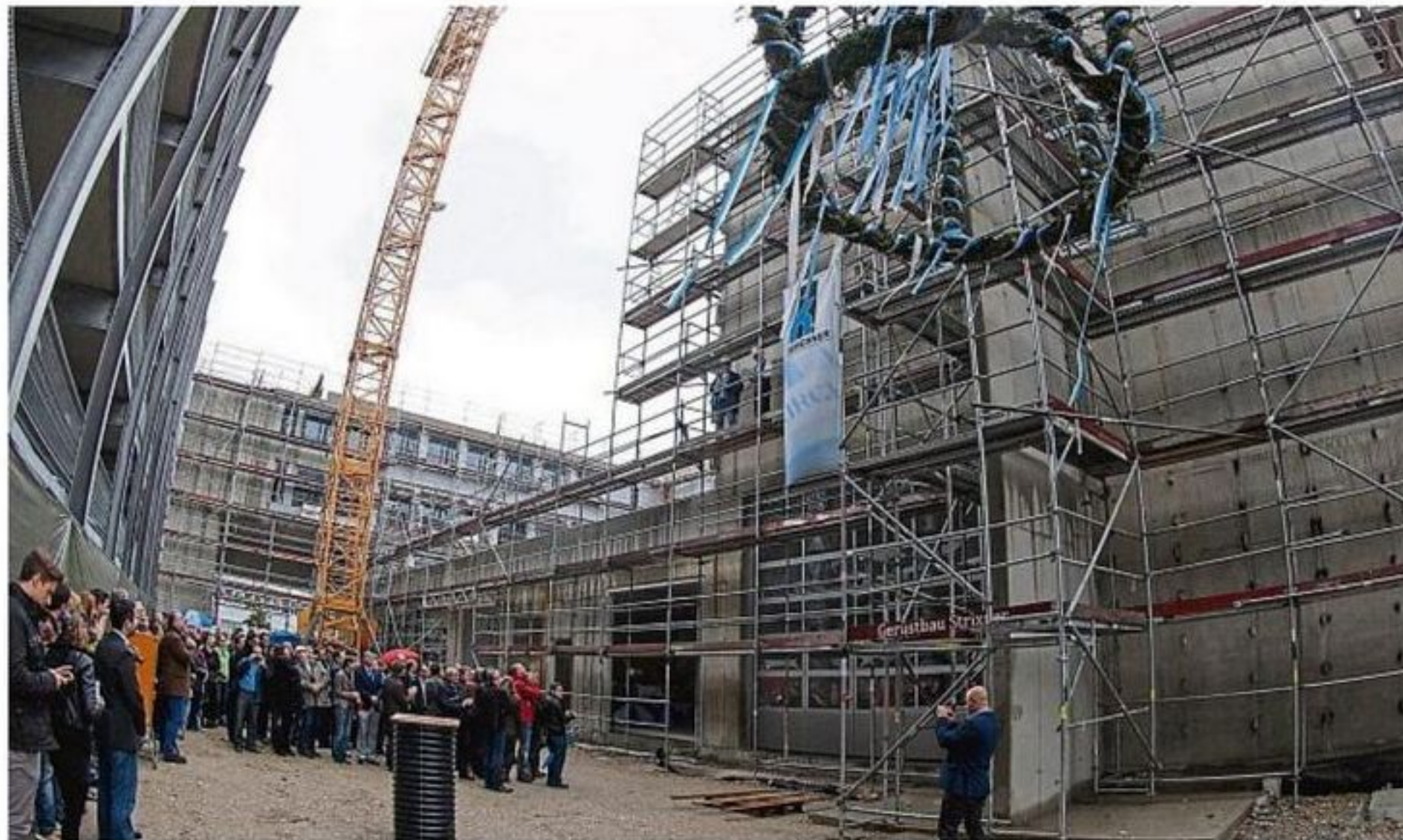
Krone von oben: Vertreter der Wirtschaft, der Politik und der am Bau beteiligten Firmen feierten Richtfest für ein weiteres Gebäude im Gilchinger ASTO-Park. Es bietet 6500 Quadratmeter Fläche und wird der Sitz des Busklimatisierers Spheros. FOTO: AJ
